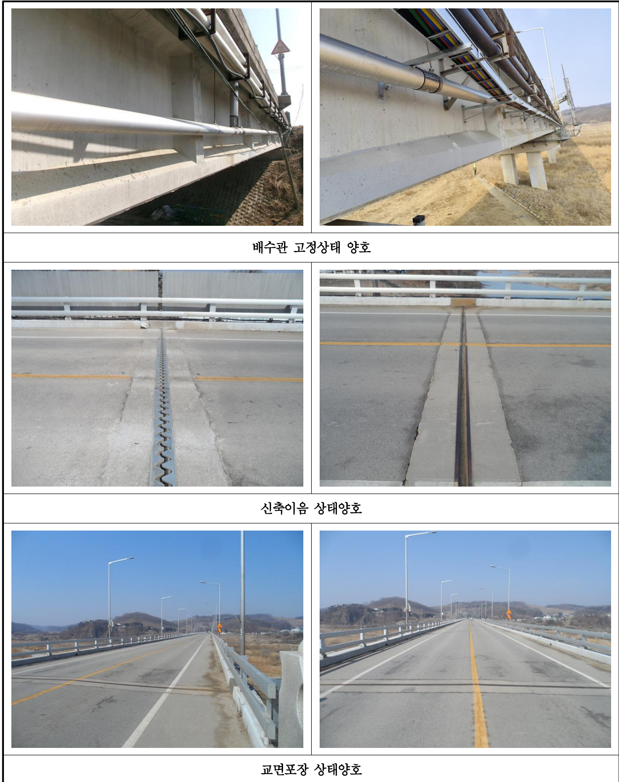
【사진 3.33】 교량의 공중이용시설 10대 위험요소 손상현황(계속)
