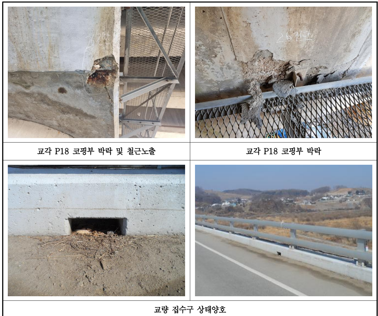
【사진 3.33】 교량의 공중이용시설 10대 위험요소 손상현황
